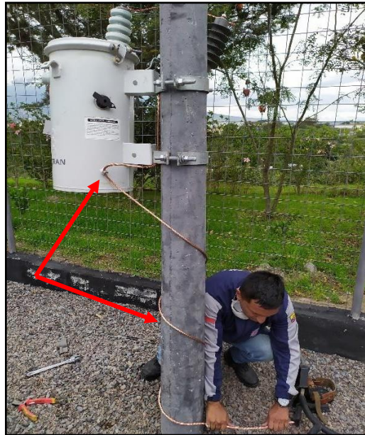
Fig. 3.18 Conexión de la puesta a tierra con la carcasa del transformador. Fuente: Autor.
