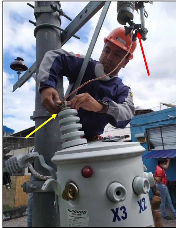
Fig. 3.8 Conexión del seccionador. Fuente: Autor.
