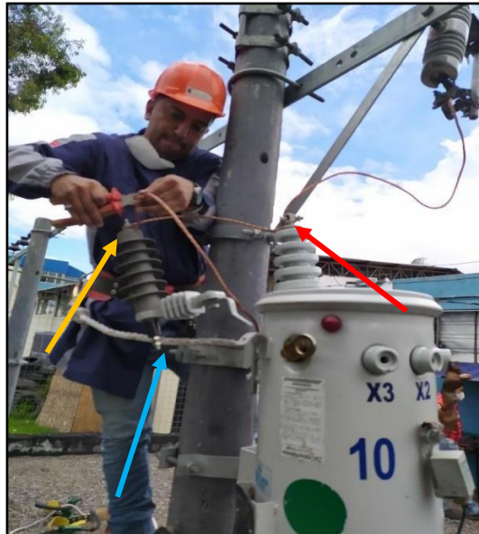
Fig. 3.4 Conexión del pararrayo. Fuente: Autor.
