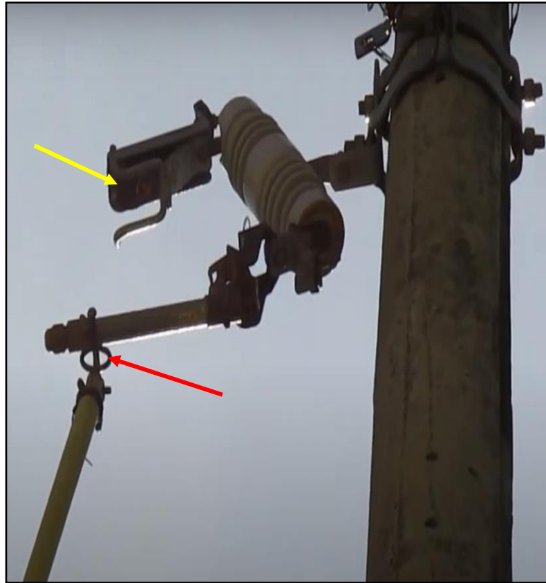
Fig. 3.11 Maniobra de cierre del portafusible. Fuente: Autor.
