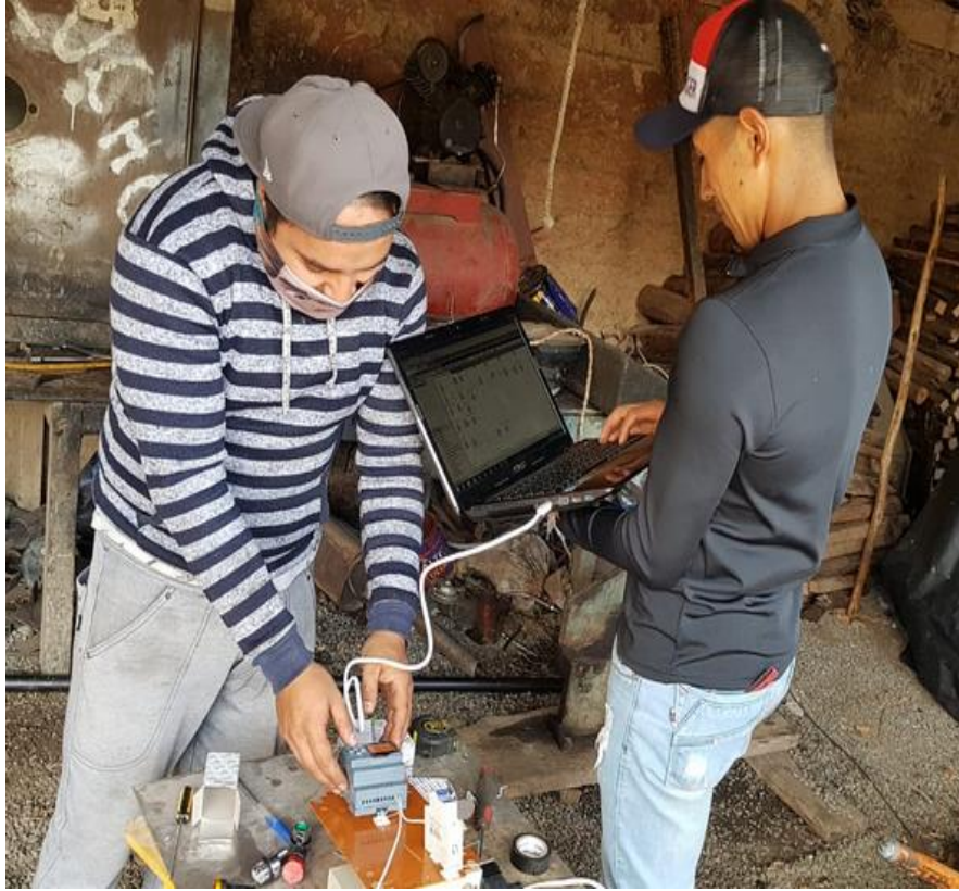
Figura A IX.3. Instalación del sistema electrónico
