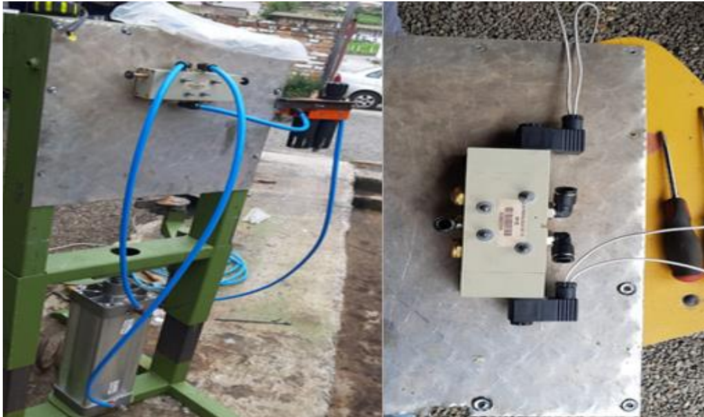
Figura 3.16 Conexión física del circuito electro neumático
