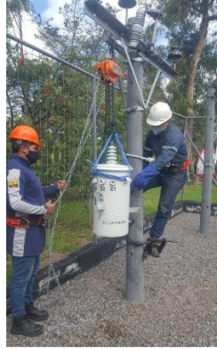
Figura 7. Acenso del transformador.
