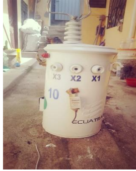
Fig. 38. Transformador de 10kv tipo poste.
