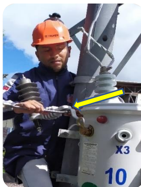
Figura 11. Ensamblado del pararrayo
