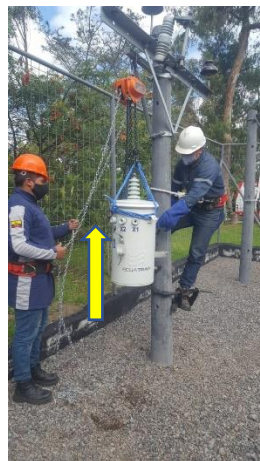
Fig. 43.- Acenso del transformador.
