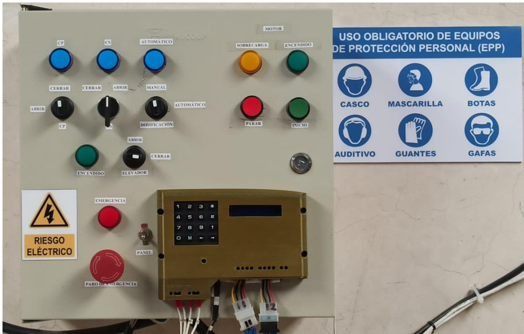
Figura 66. Tablero de control eléctrico.
