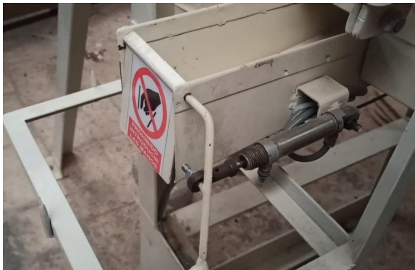
Figura 69. Pistón neumático instalado.
