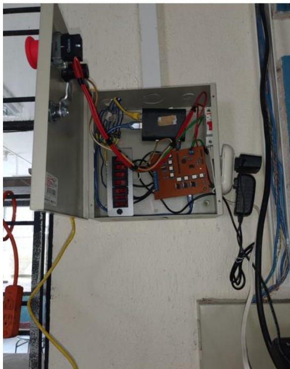
Fig. 65. Conexión eléctrica en los laboratorios. Fuente: Elaborado por el autor
