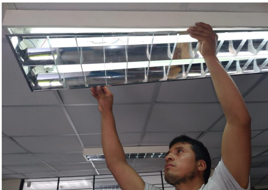
Fig. 62. Cambio de luminarias. Fuente: Elaborado por el autor
