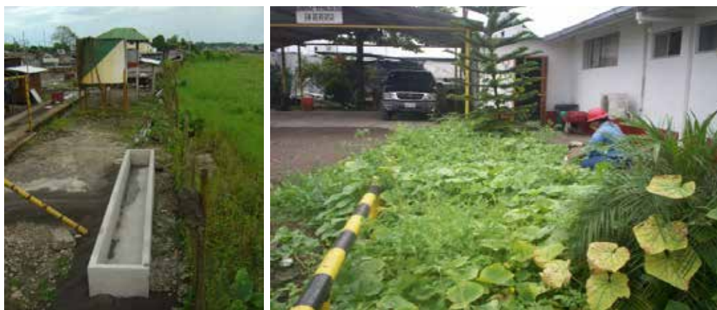
Figura 4.22. Tratamiento de lodos. A) Lecho para disposición final de lodos residuales B) vegetación crecida sobre los lodos residuales tratados
