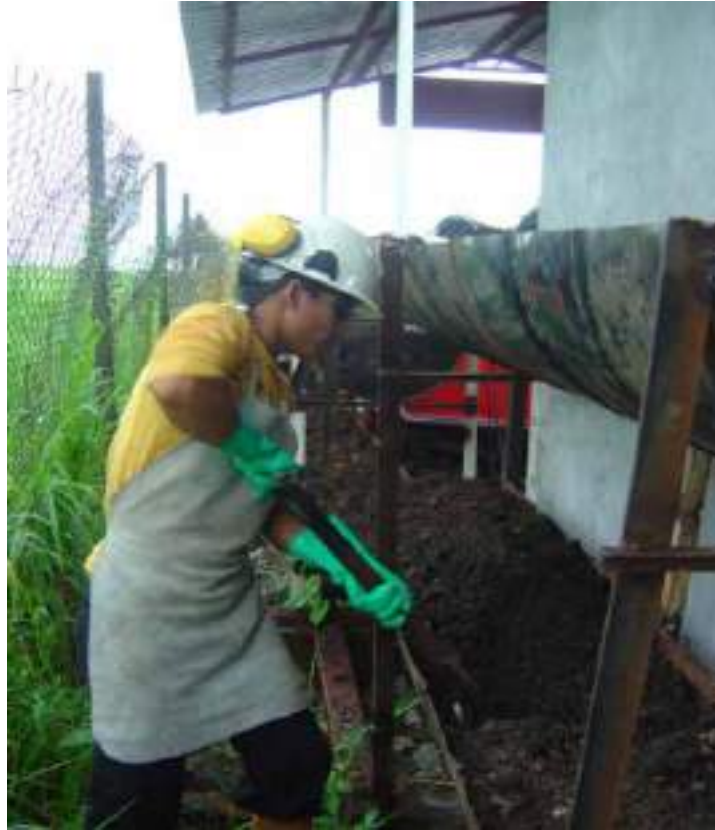
Figura 4.21 Almacenamiento y estabilización de lodos residuales en tanques.
