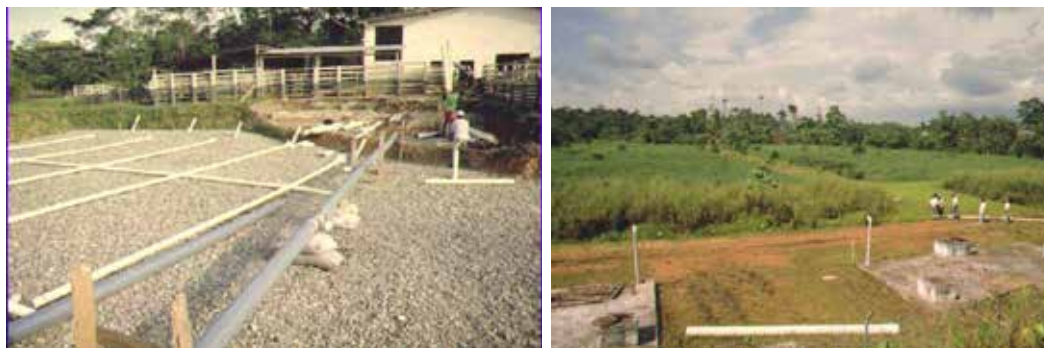
Figura 4.41. Tubería de distribución y humedal para aguas residuales en Shushufindi Ecuador
