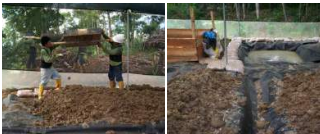
Figura 7.5.4. Conformación de pilas. a) Tendido de material deshidratado b) construcción de pilas dentro de las unidades experimentales
