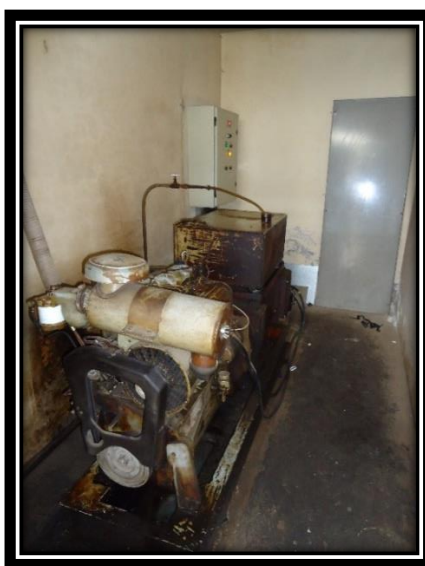
Figura 23. Generador de emergencia Fuente: Autor
