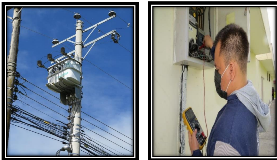
Figura 19. Acometida transformador 45 kVA Fuente: Autor
