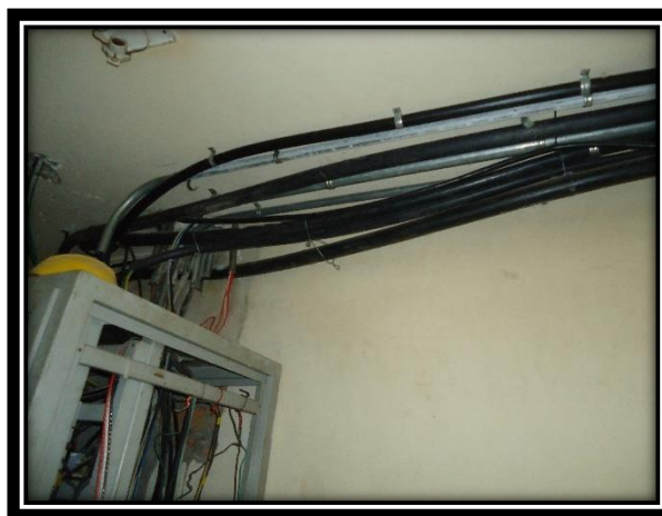
Figura 18. Acometida aérea Fuente: Autor
