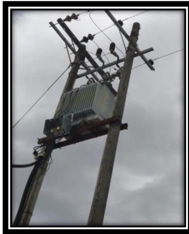
Figura 17. Transformador de alimentación 100kVA Fuente: Autor
