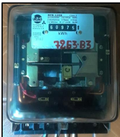
Figura 42. Medidor Electromecánico Bifásico
