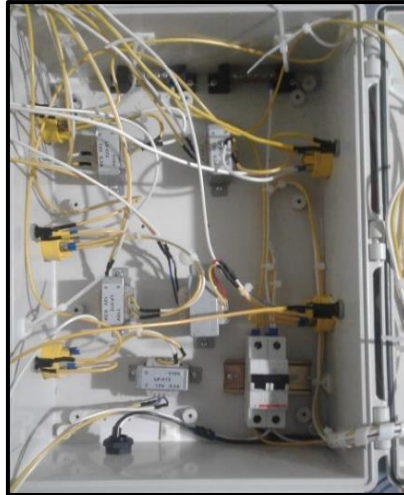
Figura 36. Conexionado entre tomacorrientes, transformadores y simultáneamente entre los sensores y módulos relé.
