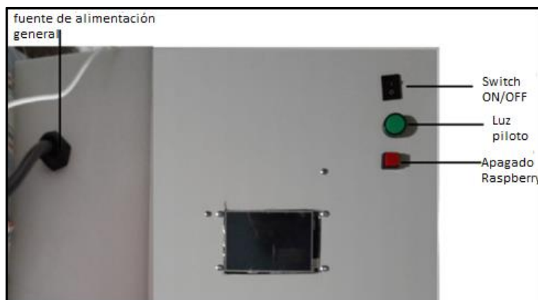
Figura 35. Montaje de los botones switch, luz piloto, RESET y fuentes de alimentación.
