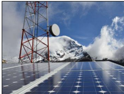
Fig. 22. Sistema Fotovoltaico autónomo Fuente: Recuperado de https://cutt.ly/RNuv4OP
