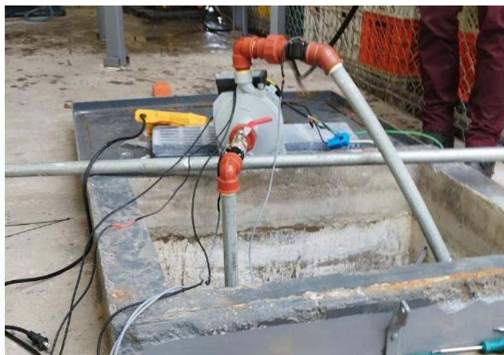
Bomba ensamblada en un circuito hidráulico
