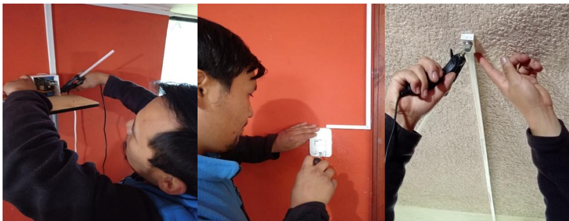
Fig. 74 Instalación de elementos domóticos en el área de la cocina Fuente: (Autor,2023)
