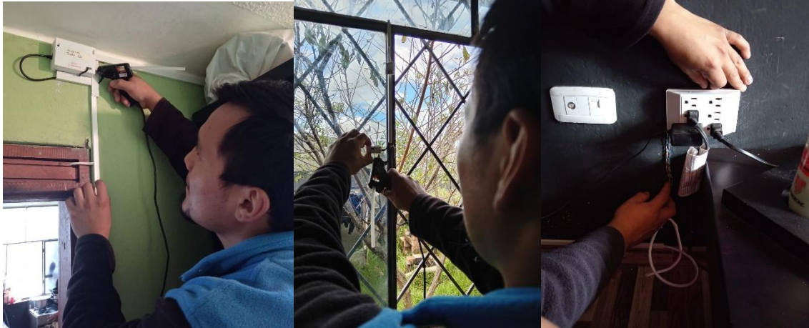
Fig. 78 Instalación de elementos domóticos en el área de dormitorios Fuente: (Autor,2023)
