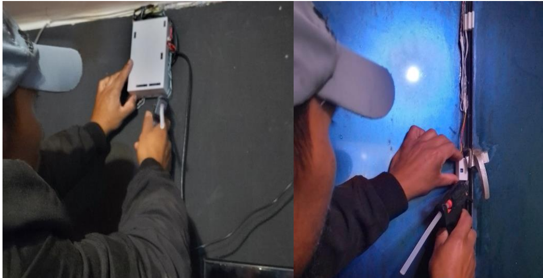
Fig. 72 Instalación de elementos domóticos en el área del comedor Fuente: (Autor,2023)
