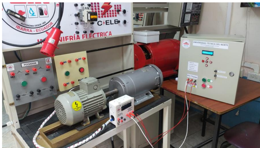
Fig 46. Prueba del Módulo con Carga (Motor-Generador DC) Fuente: Autor
