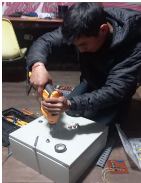
Fig 38. colocación elementos HMI en el Tablero Fuente: Autor
