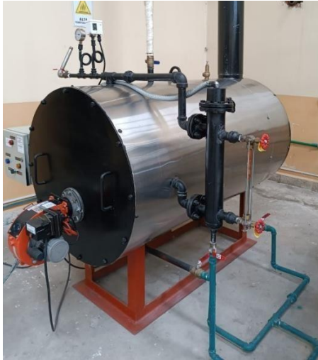
Caldero de la planta textil
