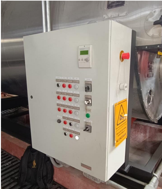
Anexo No 17. Tablero de control Caldera FLORAL S.A.
