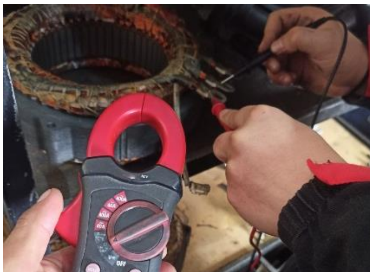
Figura 4.13 Medición de bobinados
