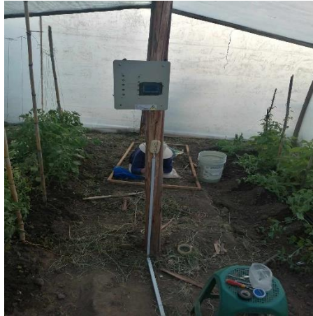
Figura 26. Montaje del sistema en el invernadero
