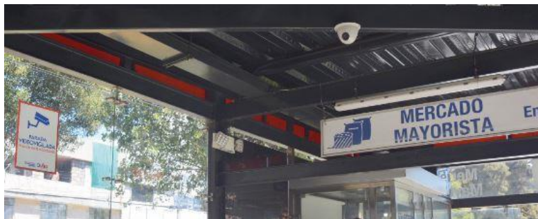
Figura 2.28 Cámara de seguridad
