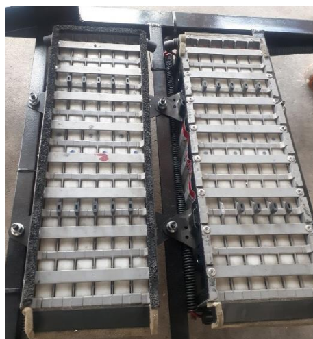
Figura 2.5. Banco de baterías
