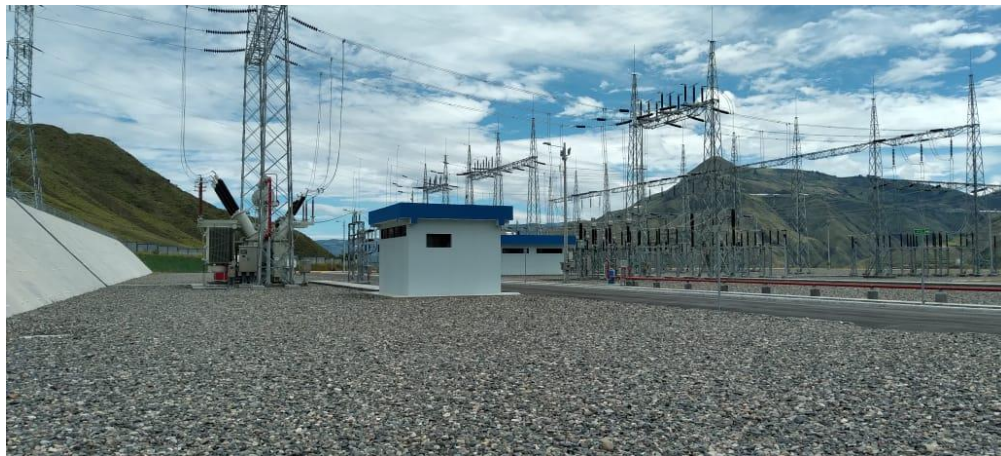
Figura 3. Subestación eléctrica pimampiro
