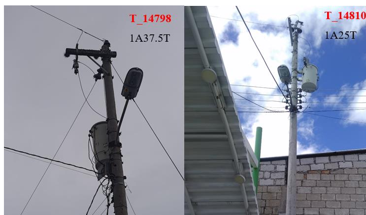
Fig. 22 Transformadores del polideportivo
