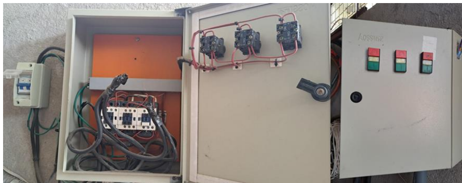
Fig. 19 Medidor de Energía y Tablero de protección Canchas Posteriores.
