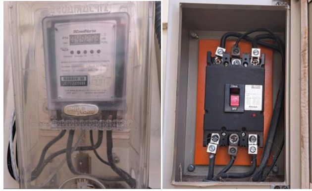
Fig. 18 Medidor de Energía y Tablero de protección Canchas Posteriores.
