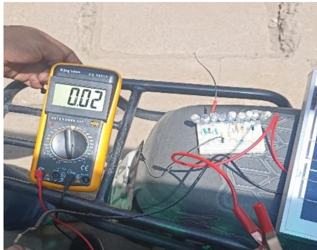
Figura 18. Medición de corriente en paneles fotovoltaicos.
