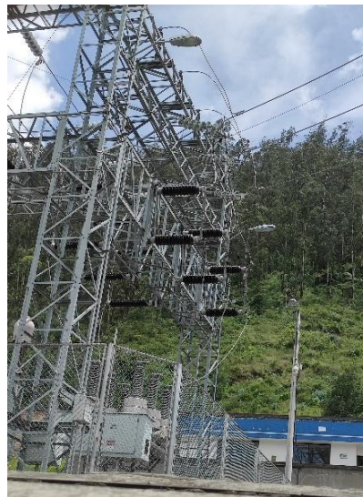
Fig. 5. Subestación de Distribución.
