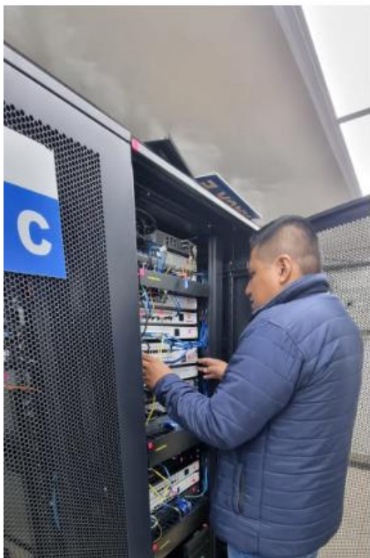
Figura 18: Instalación de equipos mikrotik en el datacenter.
