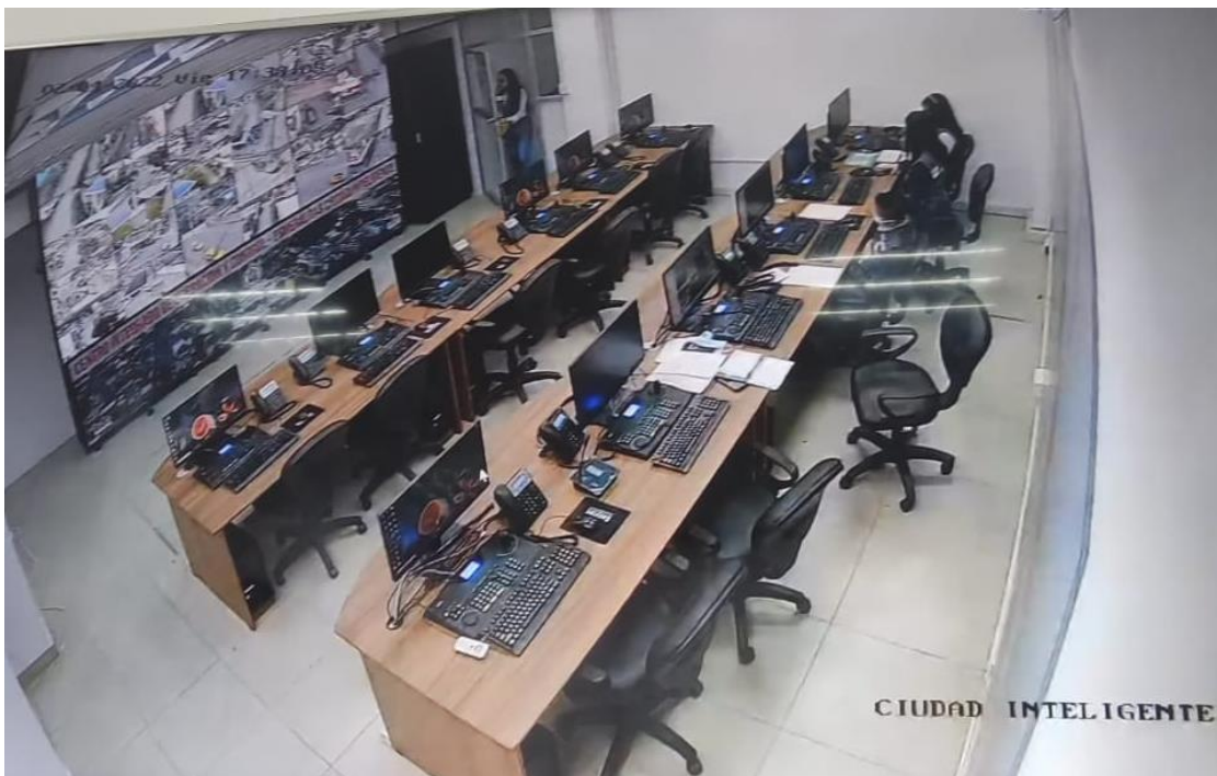
CCTV Sala de control y monitoreo de la ciudad
