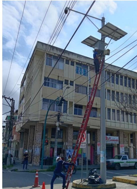
Poste de videovigilancia / wifi / sensores
