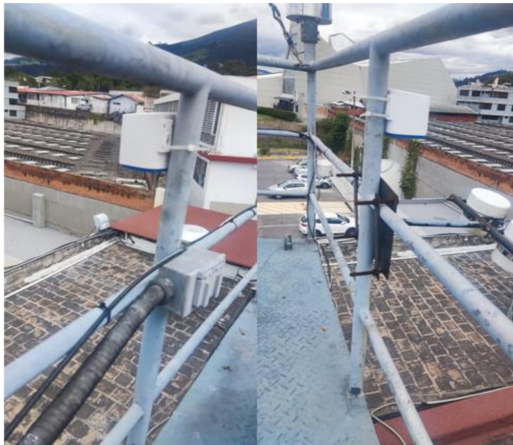
Anexo 4. Instalación de sensores AirGradient junto a la estación de referencia
