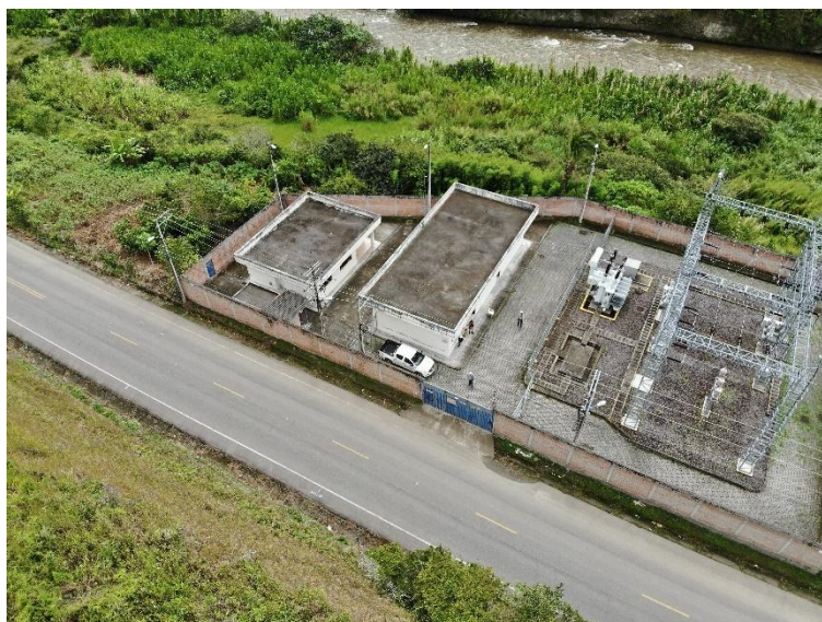
Figura 6 Subestación eléctrica La Carolina fotografiada con dron
