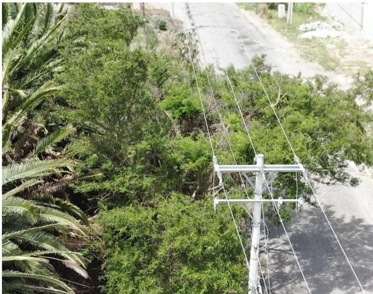
Figura 22 Vegetación topando línea de medio voltaje en el circuito K3
