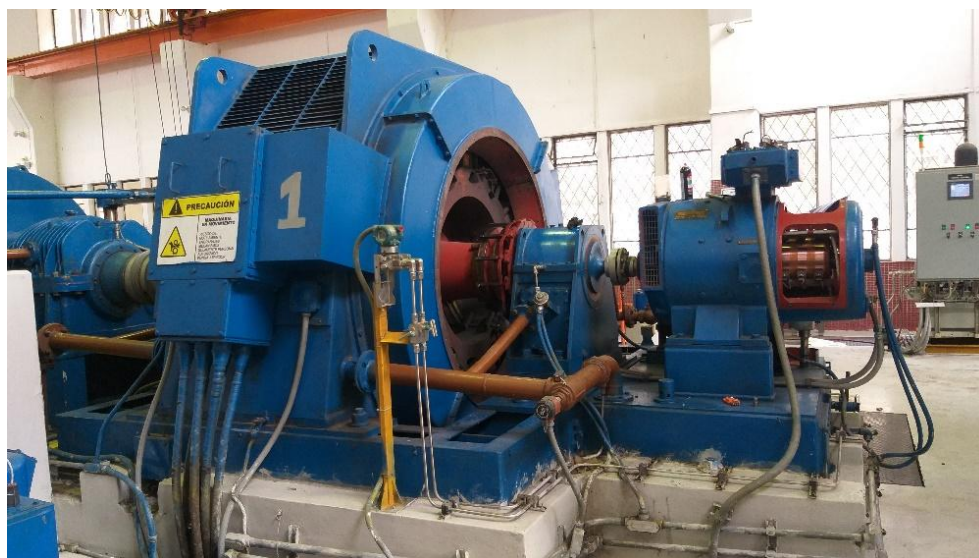
Fig. 17. Unidad generadora 1 de la C. H. del Ambi. (Generador - Excitatriz).
