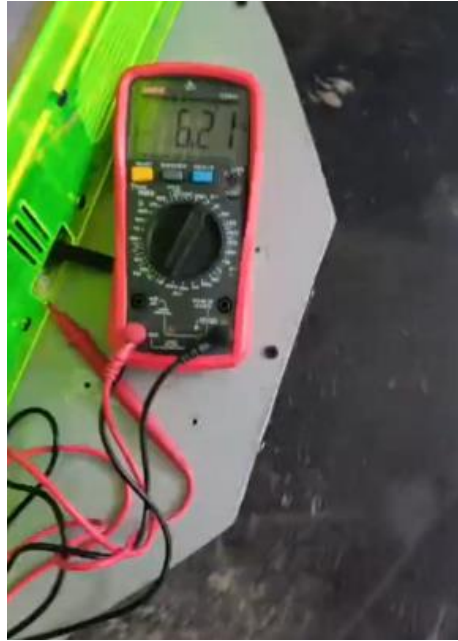
Fig. 4.38 Conexión del multímetro en serie al banco de baterías.
