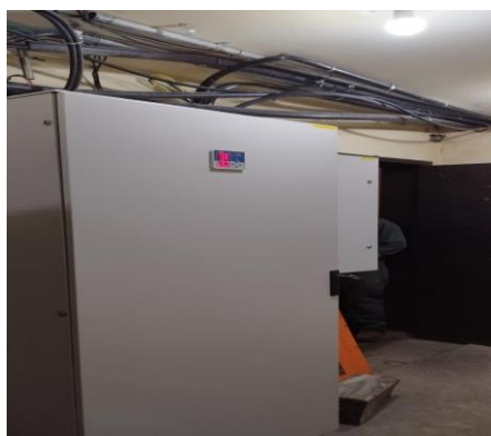
Figura 9 Tablero General de las Instalaciones Eléctricas
