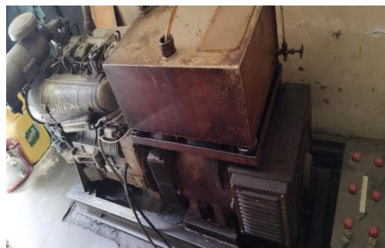
Figura 10 Grupo Electrógeno de emergencia actual de las instalaciones
