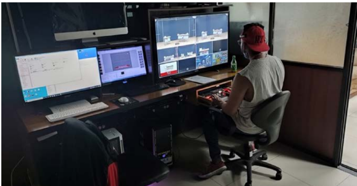
Figura 5. Control máster de Comunicación TV (Instalaciones UTV)
