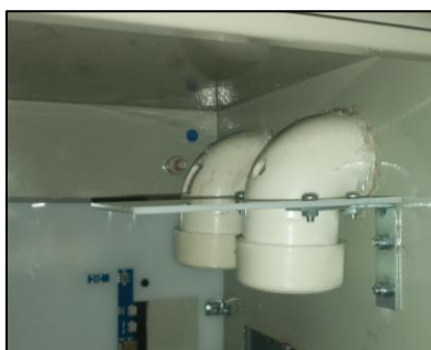
Fig. 4.92 Codos de PVC instalados.
