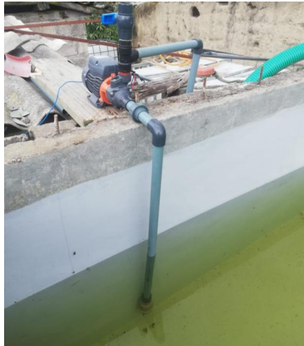
Fig. 24 Implementación del motor eléctrico
