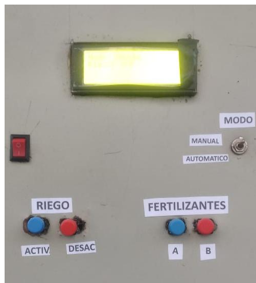
Fig. 32 Operación en modo manual
