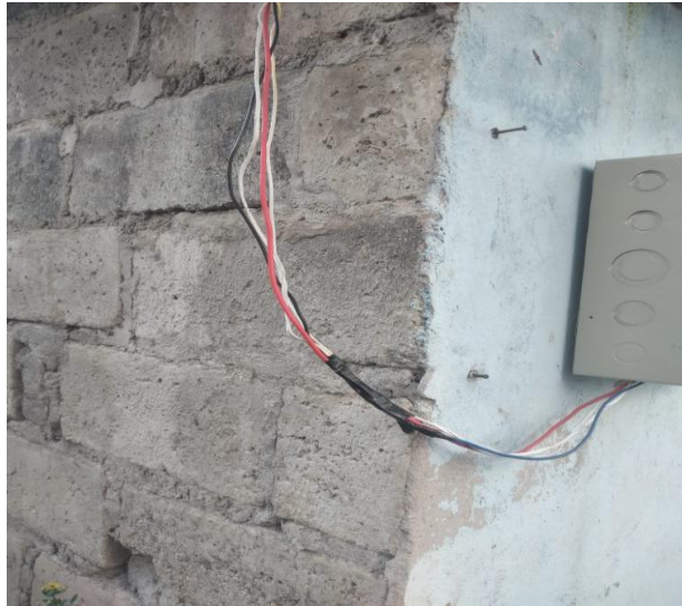
Fig. 20 cables de la red principal para el tablero
