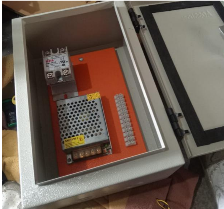
Fig. 4.0.41 Preparación de gabinete eléctrico para control.
