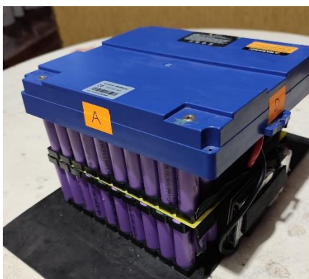
Figura 71. Etiquetado en la batería HV diagnosticada.
