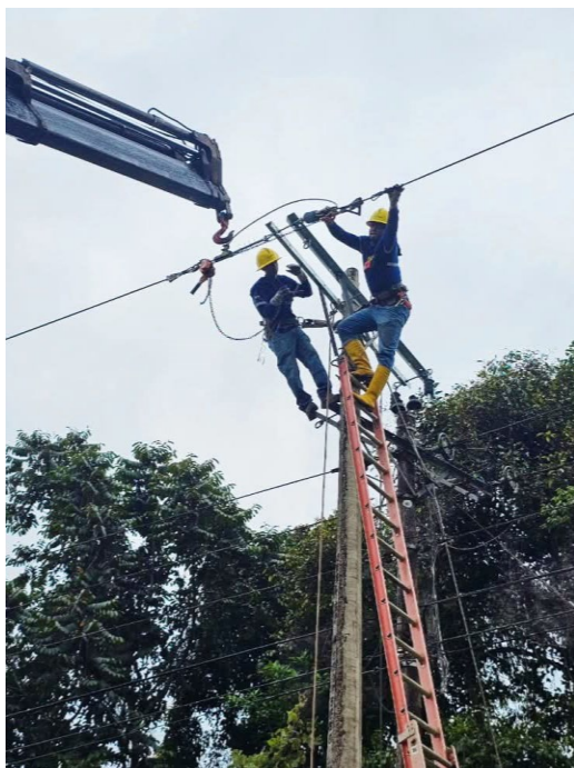
Nota: Rachado/tensado de cable eléctrico
