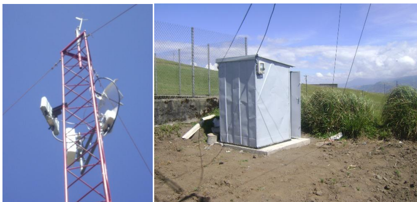
Figura 4.13. Nodos Infraestructura de telecomunicaciones
