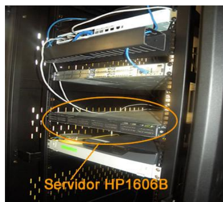
Figura 4.16. Rack de comunicaciones ubicado en el nodo central en el Municipio
