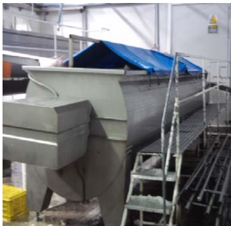
9. CHILLER DE AVES
