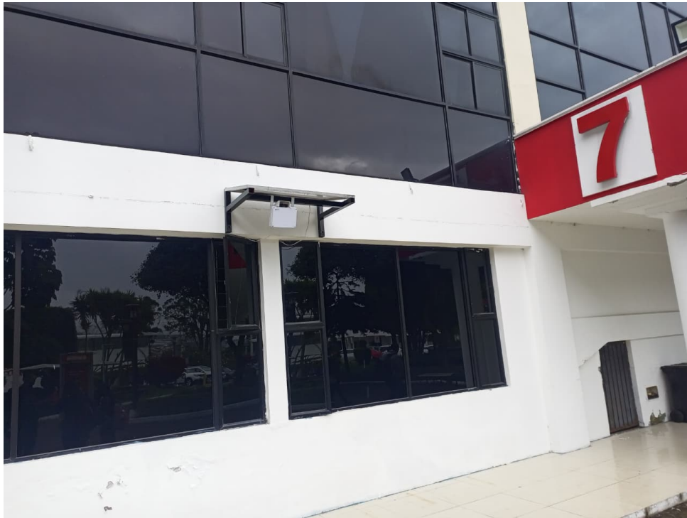
Figura A.6: Colocación sistema de monitoreo de personas
