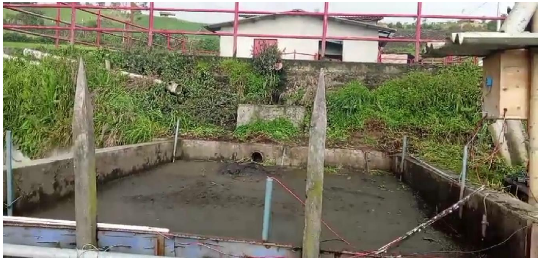
Figura 48 Sistema instalado en el establo ganadero.
