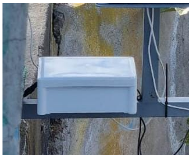
Figura 5.2: Caja de protección IP55 instalada
