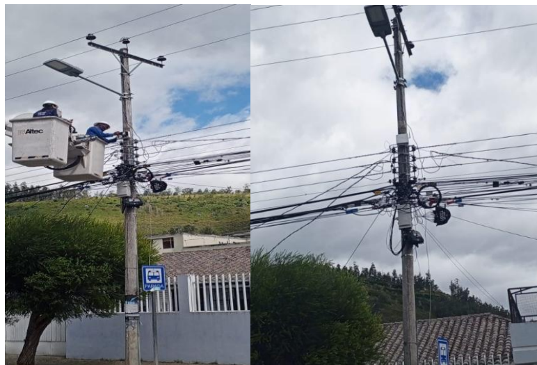
Fig 72. Montaje de luminarias LED y caja de control del sistema de monitoreo y control.
