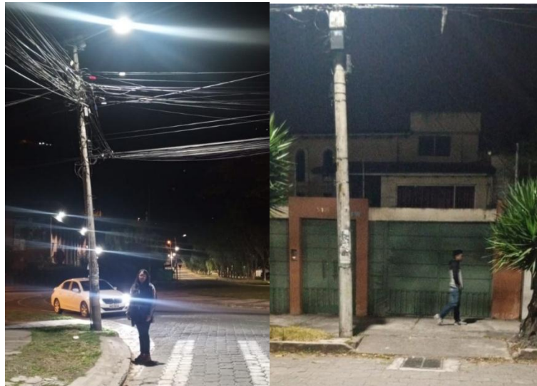
Fig 73. Inspección nocturna y validación del funcionamiento del sistema de iluminación inteligente.
