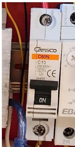
Fig. 4 Breaker principal encendido.
