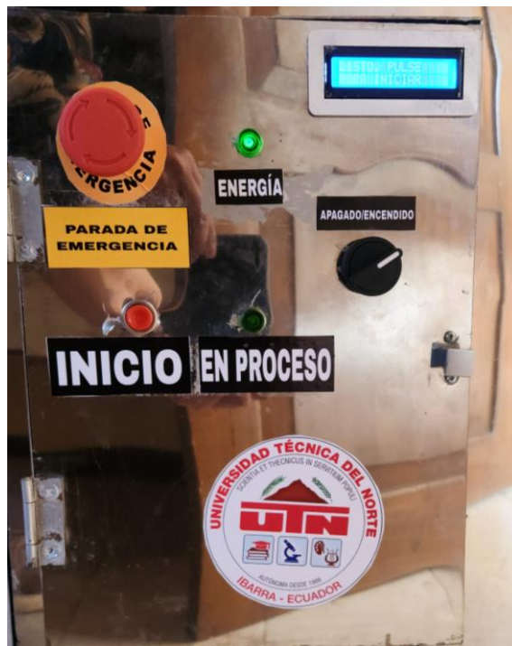
Fig. 23. Vista externa del tablero de control con la nueva distribución.
