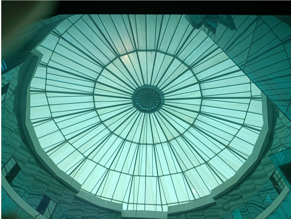
Figura A.2. Inspección visual de la cúpula
