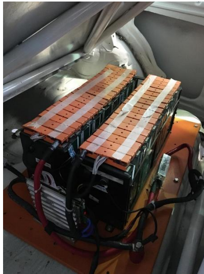
Figura 16 Banco de baterías
