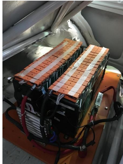
Figura 8 Banco de Baterías
