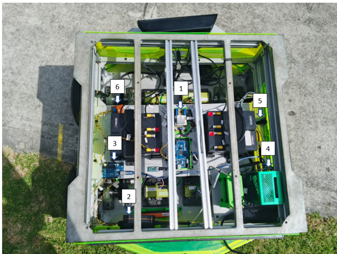
Fig. 4.20: Montaje interno de componentes eléctricos.
