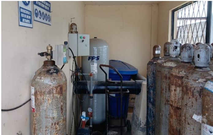
Anexo D. Cilindros de cloro gas.
