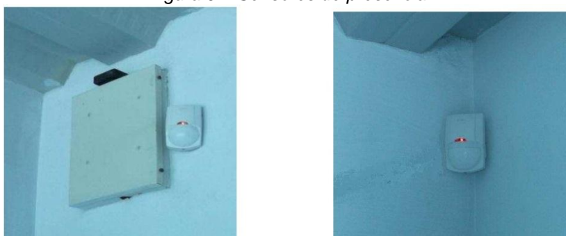
Figura 91. Sensores de presencia.
