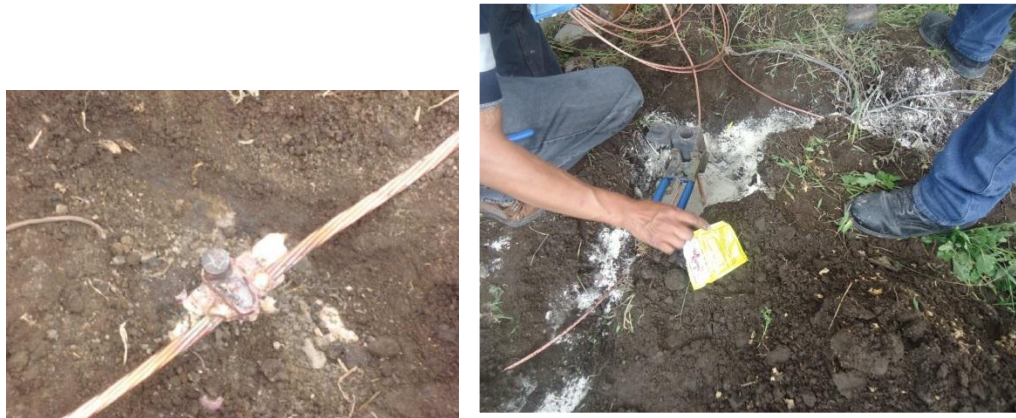
Figura 51. Conexión realizada con soldadura exotérmica.
