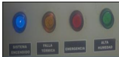
Figura 2-10 Luces piloto del tablero de control del sistema de riego
