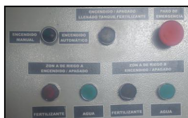
Figura 2-9: Pulsadores en el tablero de control
