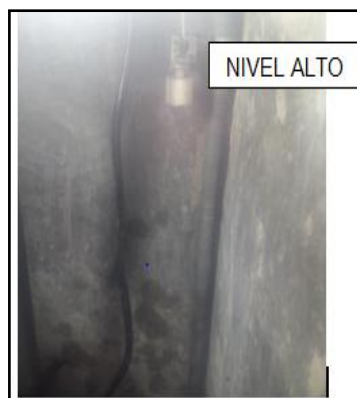
Figura 4-12: Verificación de flotadores Tanque 2
