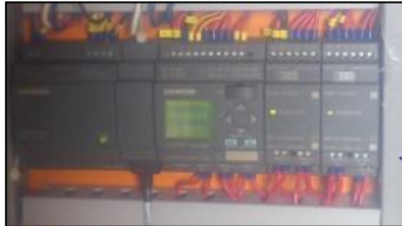
Figura 3-16: Instalación de PLC logo siemens y sus complementos
