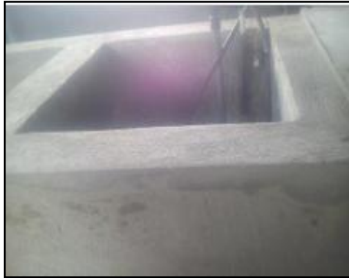
Figura 1-18: Tanque de mezcla de abonos (químicos, orgánicos)
