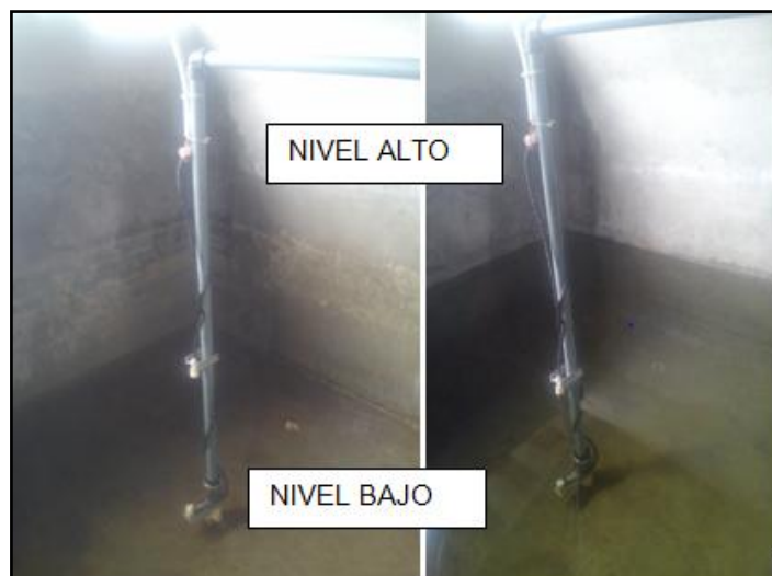
Figura 4-11: Verificación de flotadores Tanque 1
