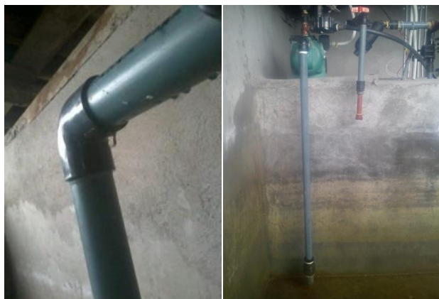
Figura 4-14 Fugas en las Tuberías
