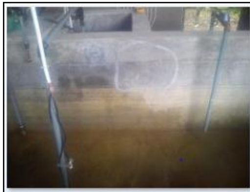
Figura 1-17: Tanque de almacenamiento de agua del sistema de riego.
