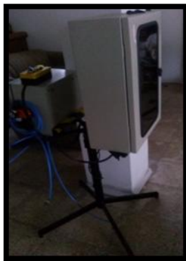
Figura 20. Gabinete y accionamiento de actuadores
