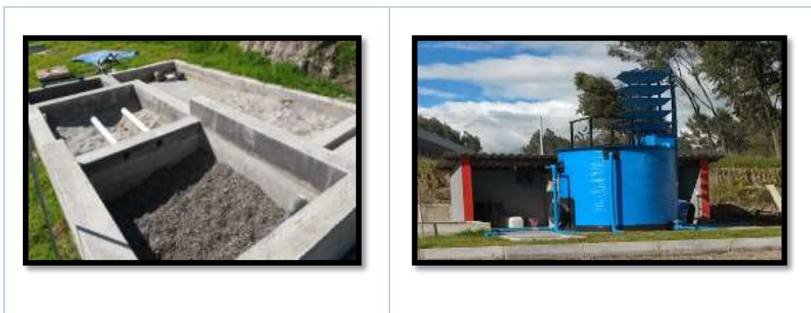
ILUSTRACIÓN 4.62: Planta de tratamiento antes y después de la implementación.
