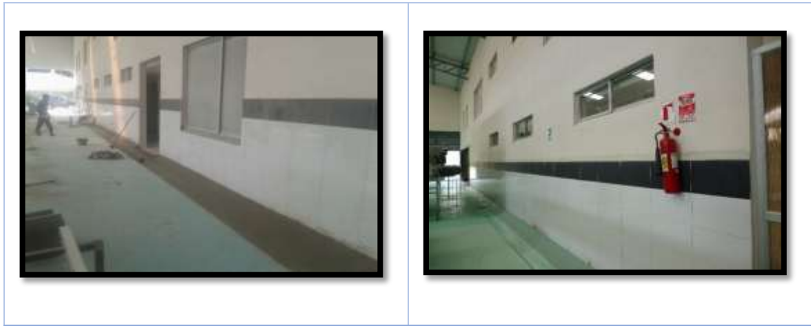
ILUSTRACIÓN 4.51: Paredes antes y después de la implementación.
