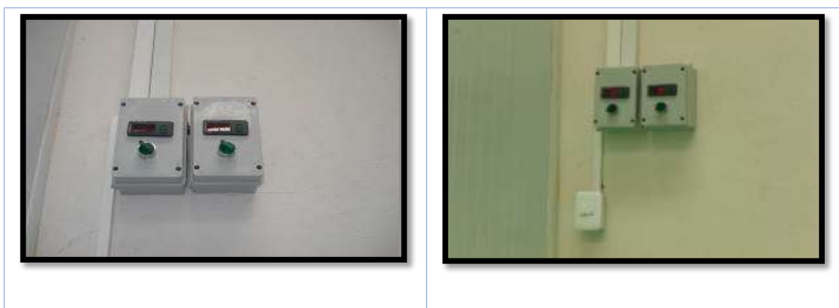
ILUSTRACIÓN 4.36: Control de temperatura del cuarto frío.
