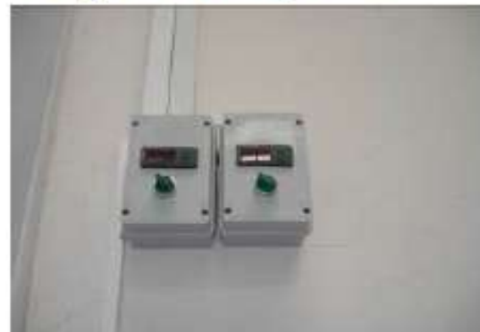
Imagen 14. Control de Temperatura de cámara.
