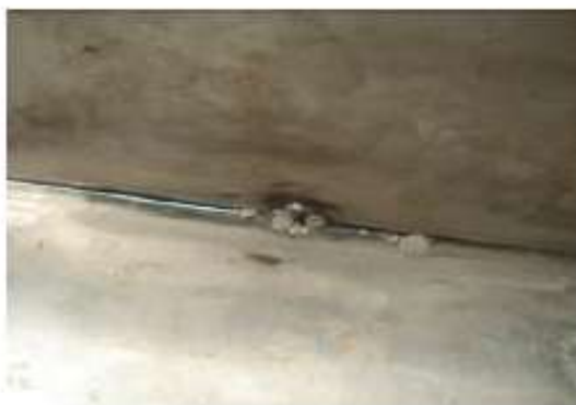
Imagen 15. Soldaduras en equipos y accesorios.
